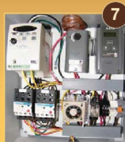
Johnson A419 Aquastat
