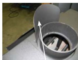
Bouclier thermique installé
